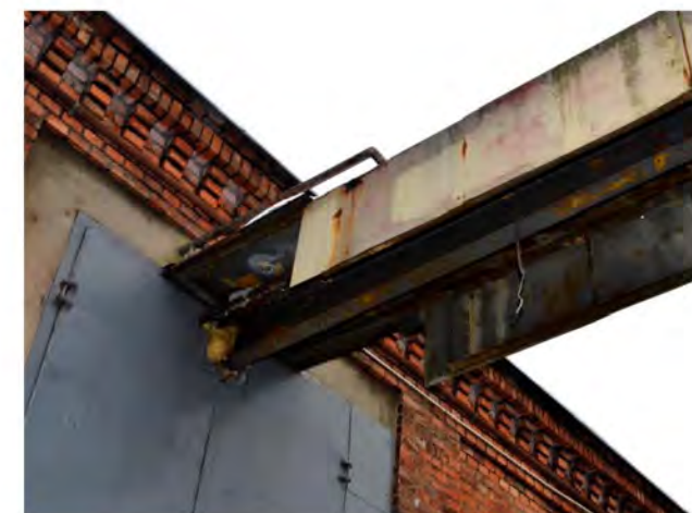
Suwnica między budynkami 4 i 5
